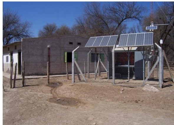
Fig. 7. Conjunto fotovoltaico y gabinete compartimentado dentro de cerco perimetral.
