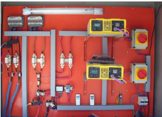
Fig. 5. Vista interior del Tablero General.
