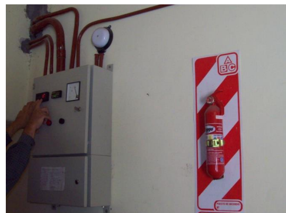
Fig. 8. Vista instalación interna: cañerías a la vista, TP y campanilla de alarma.
