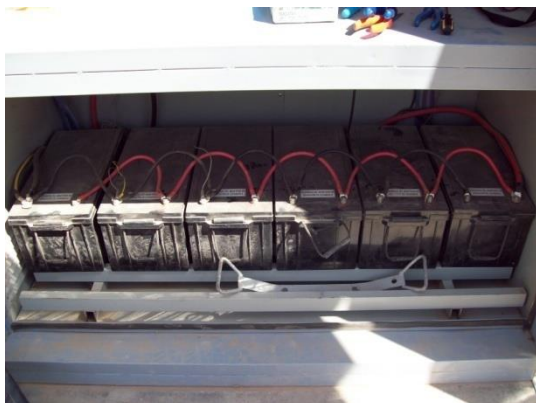
Fig. 6. Vista conjunto de baterías.
