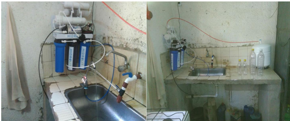
Fig. 12. Vista del sistema instalado y funcionando en la cocina de la Escuela N° 165.
