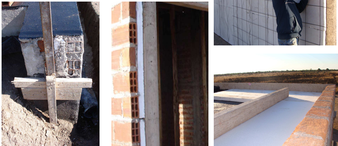
Fig. 5: Aislamiento térmico en envolvente. Protección mecánica sobre aislamiento térmico en pared este: revoque sobre metal desplegado que no fue la especificada por los proyectistas en el pliego de licitación (centro), y en pared oeste, con ladrillo cerámico (derecha).
