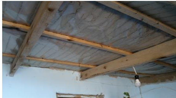
Fig. 3: Techos de chapa y polietileno con condensación
