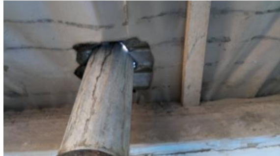
Fig. 2. Infiltración entre techo y salida de gases.
