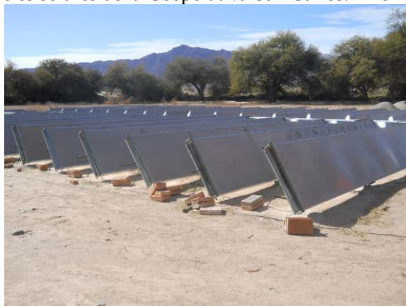
Figura N° 13. Paneles solares de la Cooperativa San Carlos. Año 2013.
