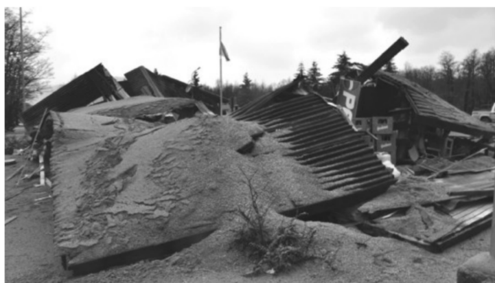
Figura 8. Techo colapsado por acumulación de ceniza. Paso Internacional Cardenal Samoré, Neuquén. Foto tomada el 8 de Junio de 2011 por Valeria Outes y Gustavo Villarosa.
