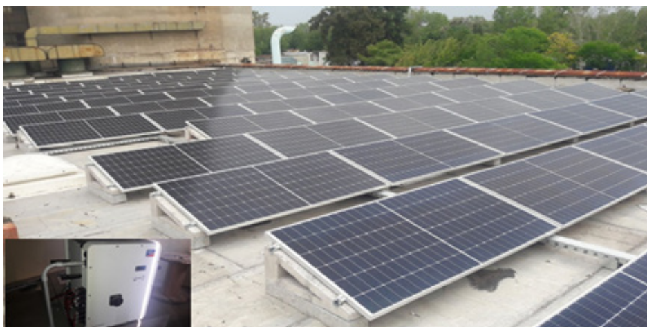
Fig. 4: Arreglo de paneles de la instalación. Se observan las estructuras de soporte de hormigón cuya inclinación corresponde a 15°. En la esquina inferior izquierda se muestra el inversor.
