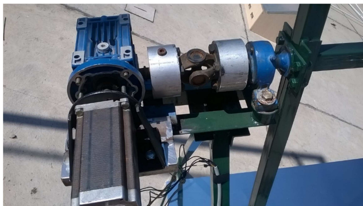
Figura 5: Sistema mecánico: motor, reductor y rodamientos
